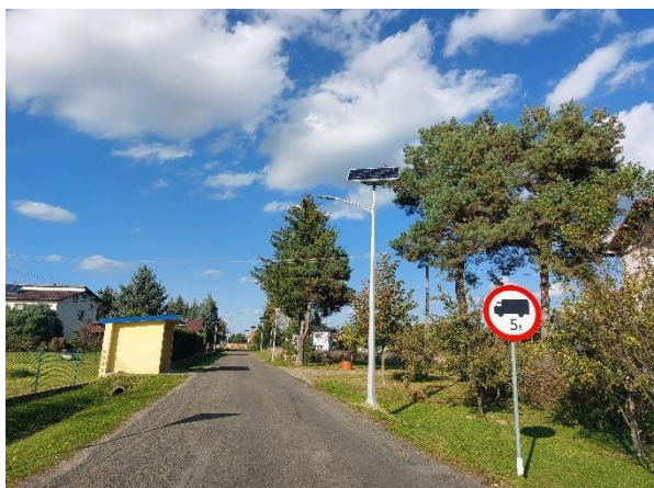
Nowe oświetlenie w Bajdach
