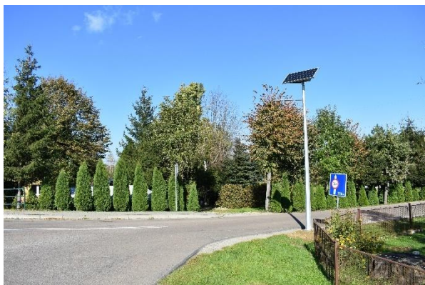
Nowe oświetlenie w Przybówce
