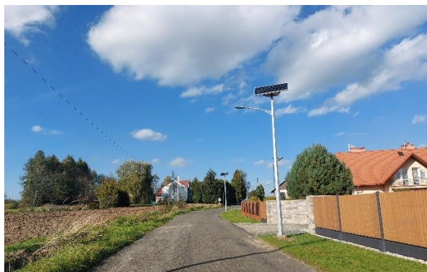
Nowe oświetlenie w Bajdach
