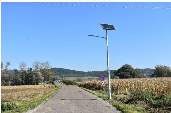
Nowe oświetlenie w Przybówce
