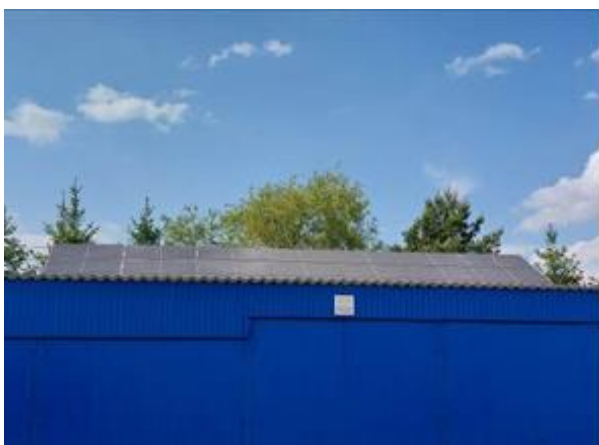
Instalacja fotowoltaiczna na oczyszczalni w Ustrobnej
