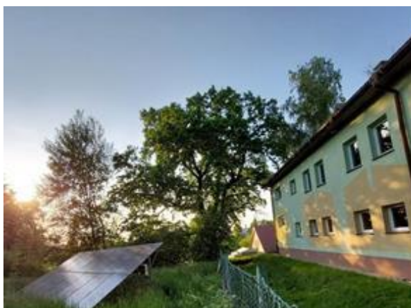
Instalacja fotowoltaiczna przy szkole w Ustrobnej
