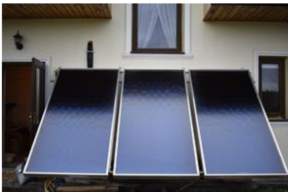
Instalacja solarna w gminie Wojaszówka
