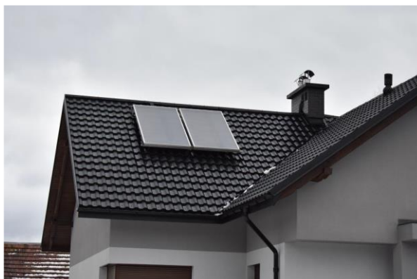
Instalacja solarna w Gminie Wojaszówka
