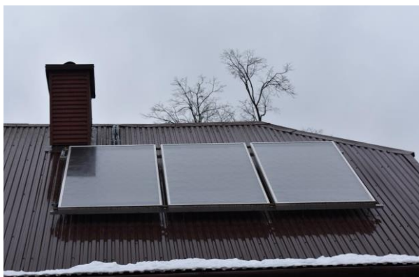
Instalacja solarna w Gminie Wojaszówka
